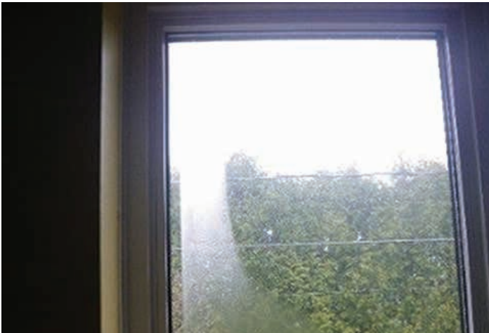
Buée entre les thermos d'une fenêtre
