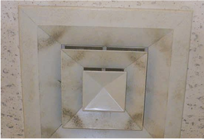
Bouche de ventilation ayant besoin d'entretien
