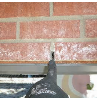
Chantepleure partiellement obstruée
