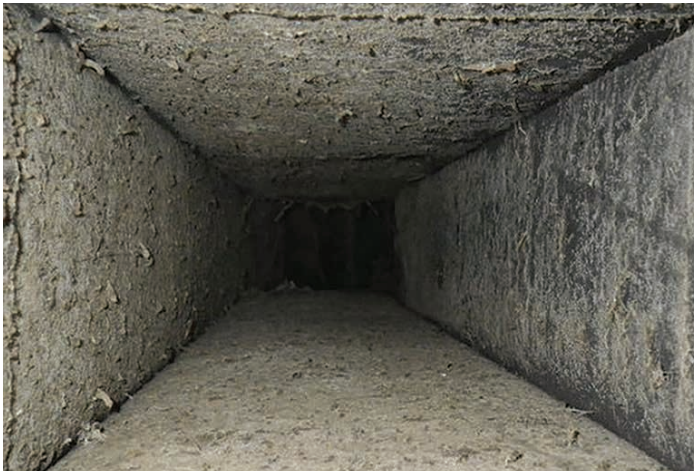
Conduit de ventilation ayant besoin d'entretien
