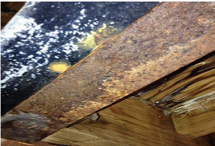
Structure d'acier endommagée sous un balcon
