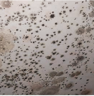
Plafond recouvert de moisissures
