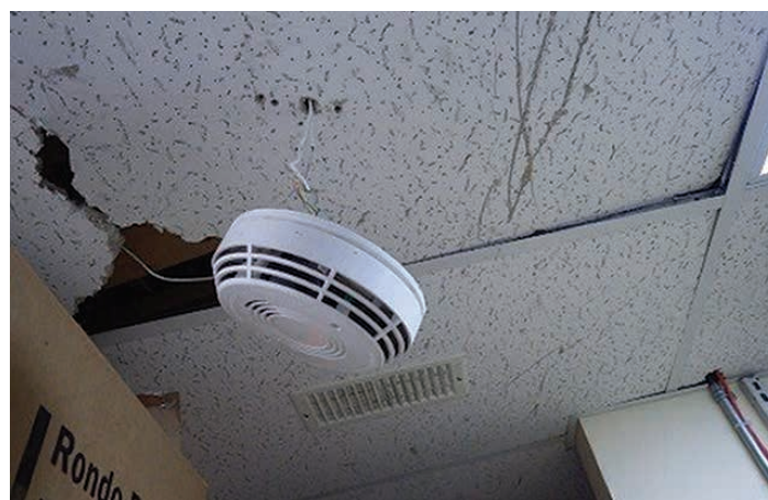
Détecteur de fumée mal fixé sur un plafond suspendu
