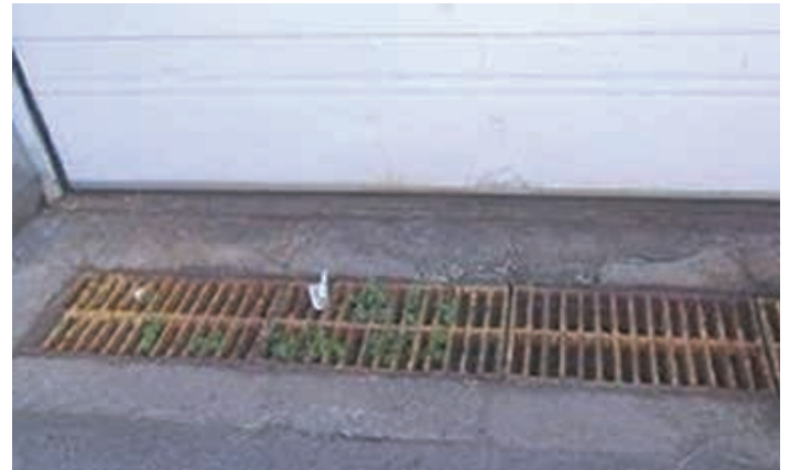
Drainage à l'entrée d'un garage partiellement obstrué par de la végétation
