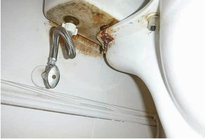
Fuite d'eau sous le réservoir d'une toilette
