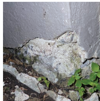
Dégradation d'un coin de fondation
