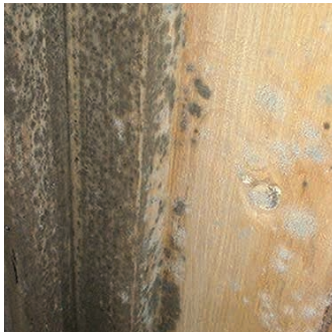
Moisissures sur un cadrage en bois
