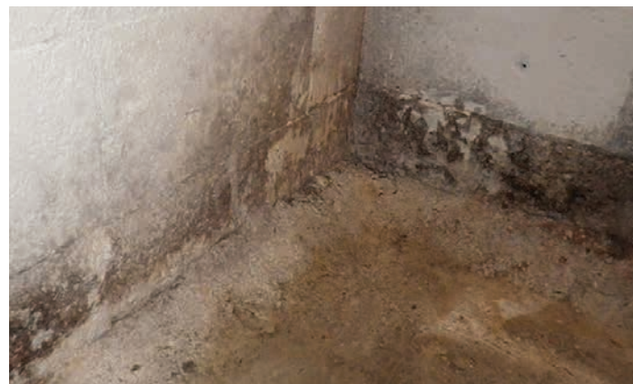
Moisissures dues à un excès d'humidité dans le sous-sol
