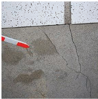
Petite fissure de crépis
