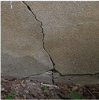
Fissure dans la fondation
