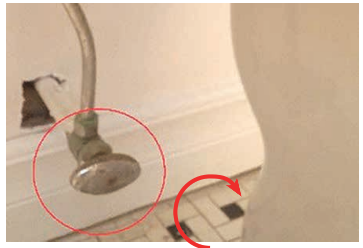
Valve de la toilette
