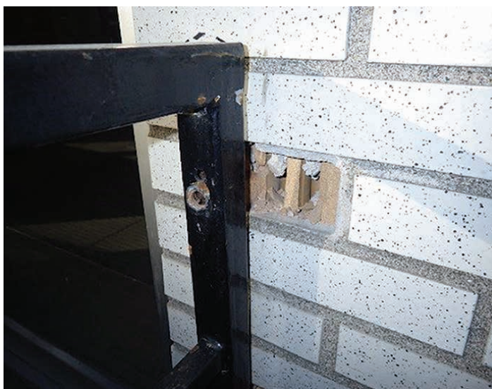
Garde-corps mal fixé au mur extérieur
