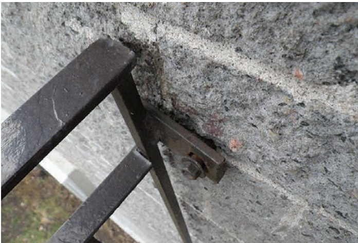
Garde-corps mal fixé
