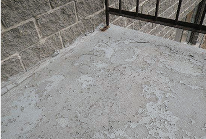
Revêtement de balcon endommagé
