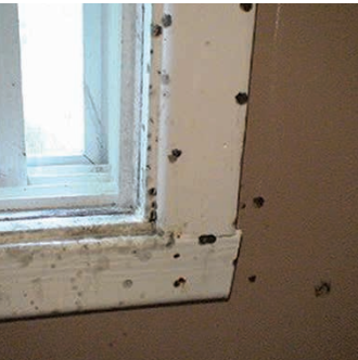
Cadrage de fenêtre avec moisissures
