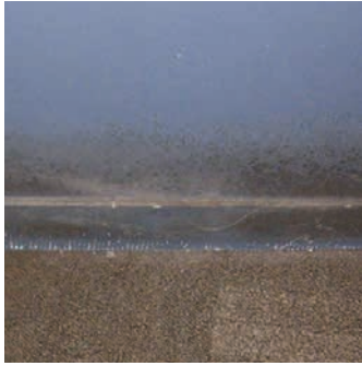
Moisissures dans le bas d'un mur
