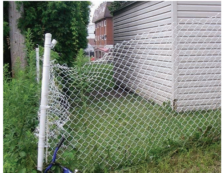
Clôture ayant subi un bris
