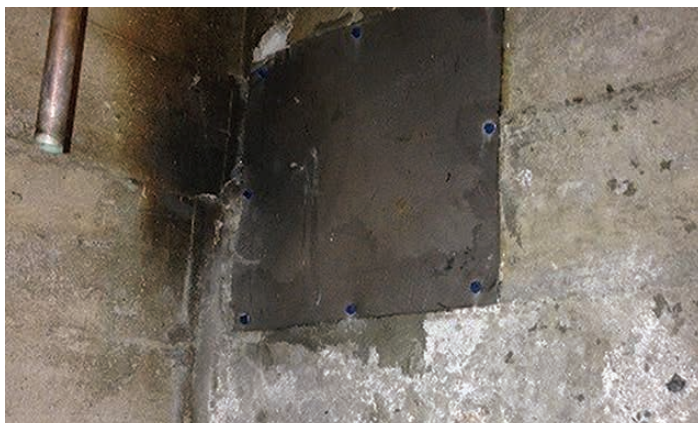
Efflorescence et cernes d'humidité dans un sous-sol
