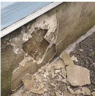
Dégradation du crépi
