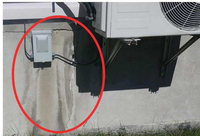
Eau de condensation coulant directement sur la fondation
