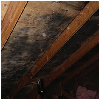
Cernes d'humidité dans un entretoit
