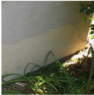
Dégradation du crépi
