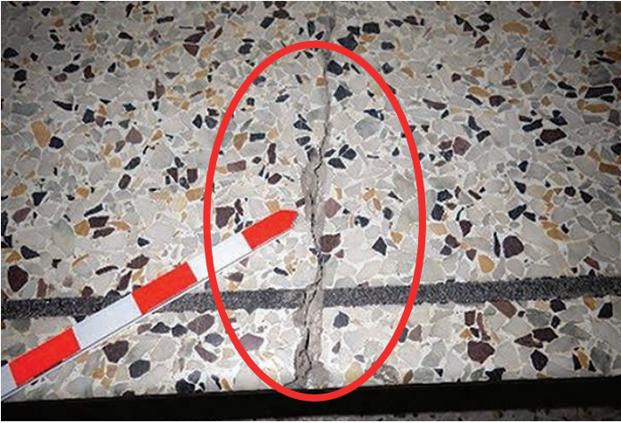
Fissure dans une marche
