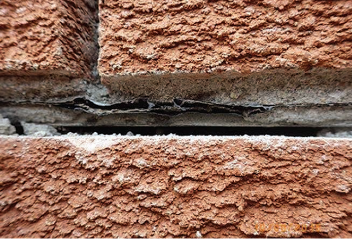
Mortier désagrégé/manque de mortier
